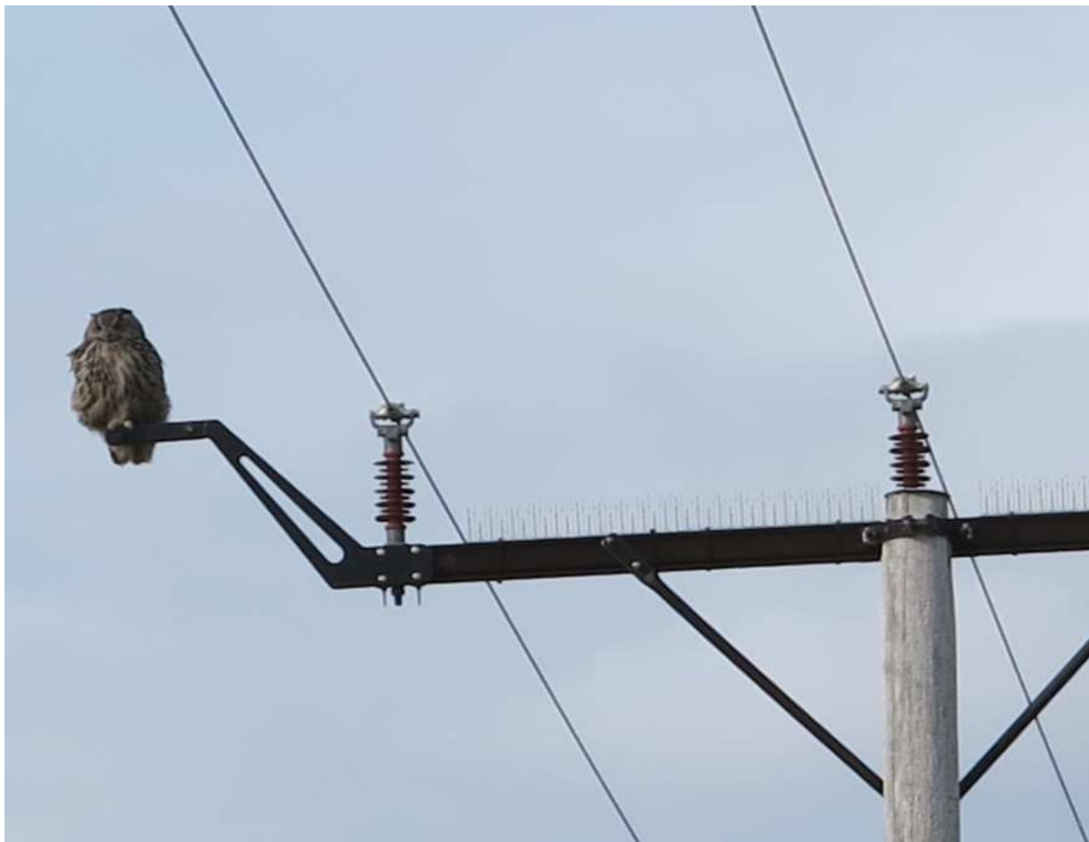
Figur 5: På ei av øyene ved Sleneset var det gjort tiltak for å sikre hubro mot kortslutning i piggisolatorene. Dette ser ut til å virke utmerket da hubroen sitter der den skal. Foto: Oddvar Olsen.
