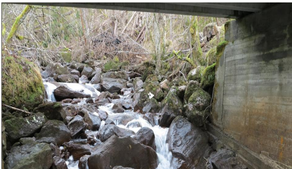
Figur 16. Biletet viser brua der bygdevegen kryssar elva. Som ein ser er botnsubstratet svært grovt. Her er bratte parti med storstein som fisk vil ha problem med å kome forbi (Foto; Oddvar Olsen © 25.02.2014).
