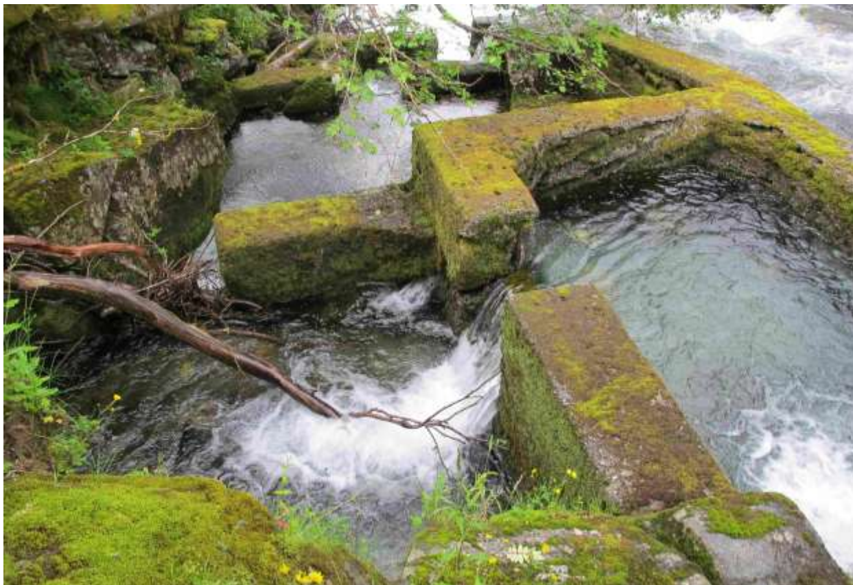
Figur 19. Dette biletet viser laksetroppa som er bygd om lag ved kote 45. Som ein ser er det kvist og kvas som ligg føre løpet ein stad, noko som gjer det meir eller mindre umogleg for fisken å ta seg fram gjennom laksetroppa no. (Foto: Oddvar Olsen © 16.08.2012).
